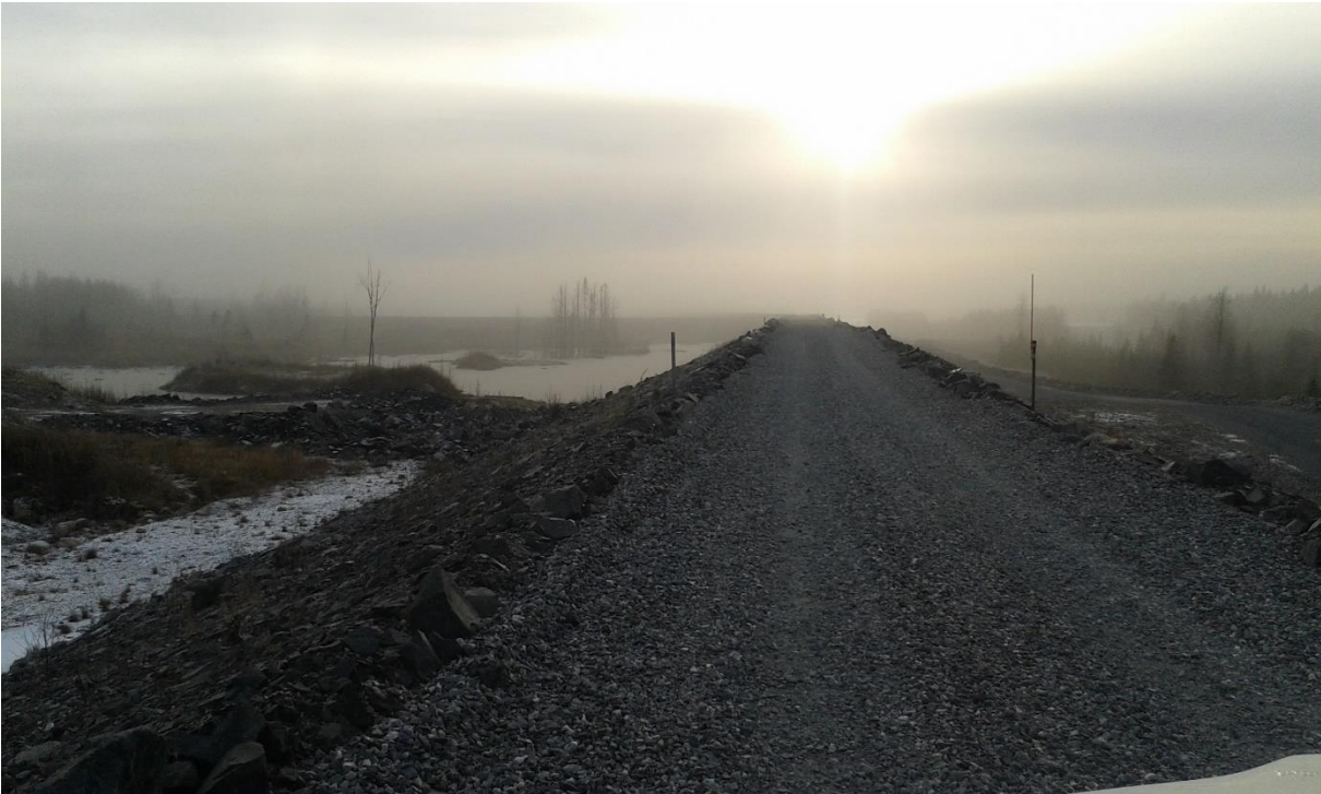
Kuva 9. Kuvassa patoalueella runsaasti pölyä. Ilmoitettava Yaran asiantuntijoille, jotta pölyn torjuntaa liittyvät toimenpiteet voidaan käynnistää.
